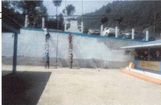
Foto 3: Pintura en muro interior.
